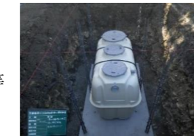
合併処理浄化槽
