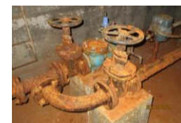
減圧弁等設備
