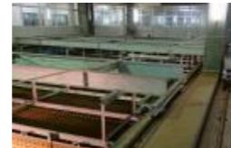
稲田浄水場 沈殿池設備 (傾斜板沈降装置)
