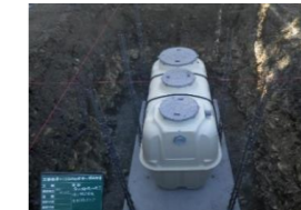
合併処理浄化槽
