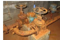
減圧弁等設備
